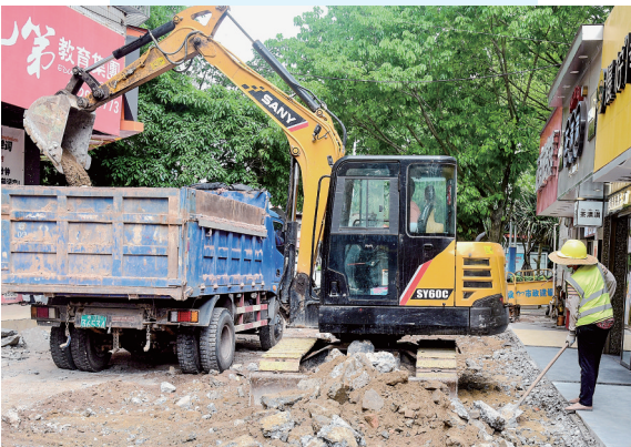
3月30日,市区光华中路官山三街道路升级改造工程施工,施工人员用钩机将旧路面进行拆除。据了解,该工程预计今年4月10日完工。
