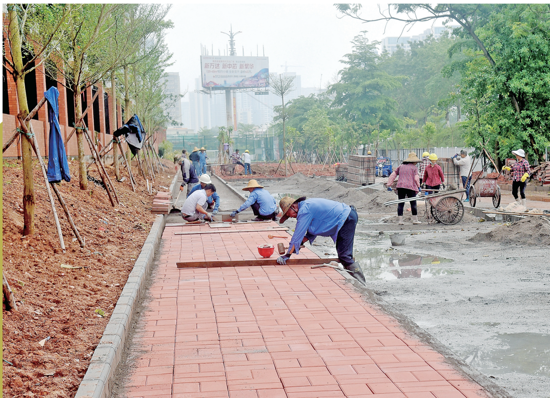
5月13日,在市区站北七路社区体育公园施工现场,施工人员正在加紧铺设人行道彩砖。据施工方介绍,目前该工程进入收尾阶段,预计月底完工。茂名日报社全媒体记者 陈国汉 摄
