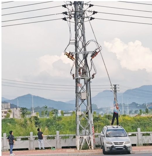
男子站车顶持竹竿捅高压线塔上的鸟窝。 通讯员文辉祥 供图
