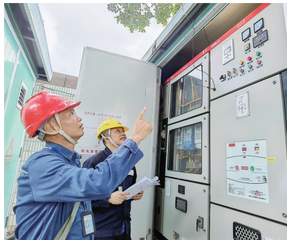
化二中考场,许鸿标和他的同事在检查用电设备的运行情况。通讯员 李文轩 摄
