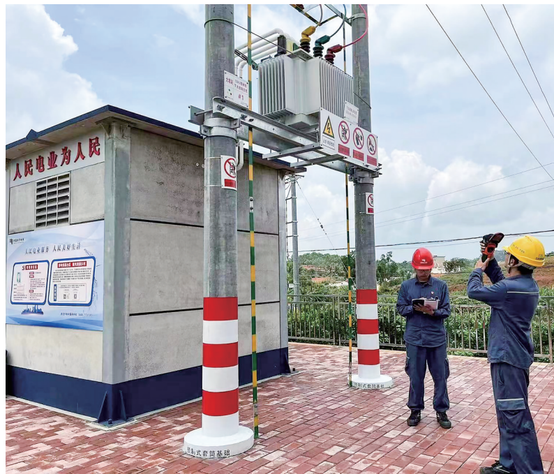
茂名化州供电局新安供电所党员服务队对新塘村委会辖区内配变进行测温检查。 通讯员陈美影 摄
