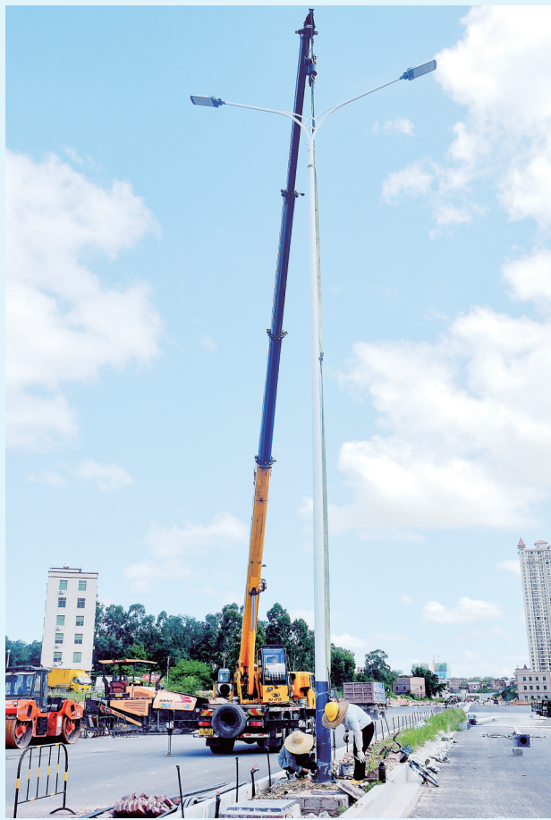
前日,记者在市区东粤路项目建设施工现场看到,施工人员正在加紧吊装路灯。据了解,东粤路项目油城十路以北路段灯杆预计本月30日前安装完成。
