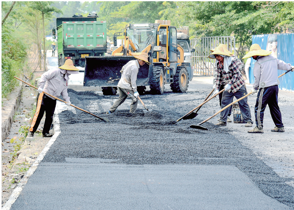
昨日,市区站北七路大田头村道路“黑底化”改造工程动工,施工人员冒着高温酷暑,摊铺沥青路面。该工程完成后,村民出行将更舒适便捷。
