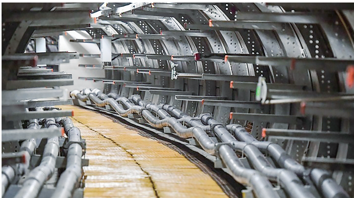
这是8月4日拍摄的长沙市万家丽路电力隧道内一角。新华社记者 陈泽国 摄
