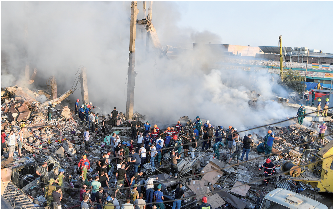
8月14日,救援人员在亚美尼亚首都埃里温的购物中心爆炸现场工作。 新华社发(阿萨塔·耶塞恩茨摄)
