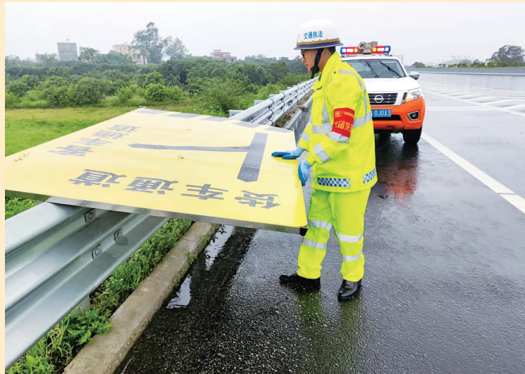
茂湛高速路政人员及时上路清理被台风吹倒的指示牌。
