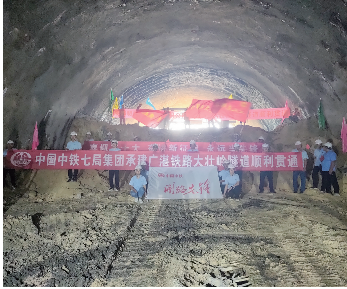
◀ 中铁七局广湛铁路项目大壮岭隧道贯通。茂名晚报通讯员任云飞 摄
