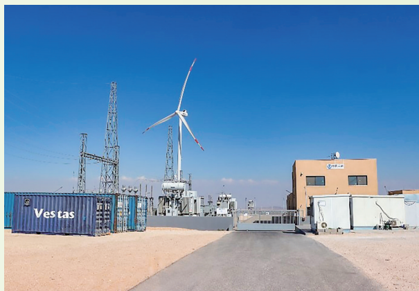
▲这是2022年9月19日拍摄的由中资企业三峡国际管理运营的约旦舒巴克风电站。(新华社记者冀泽摄)
