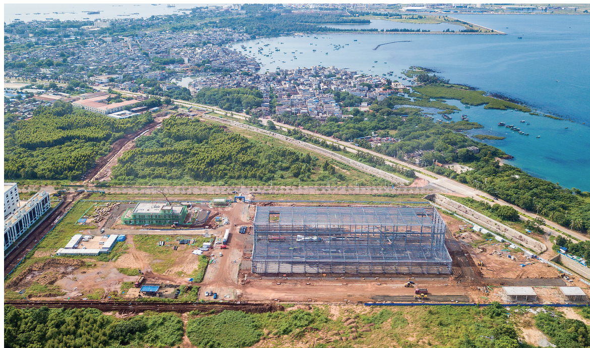
图为10月2日在海南洋浦经济开发区拍摄的建设中的申能电气风电新能源装备产业项目(无人机照片)。
