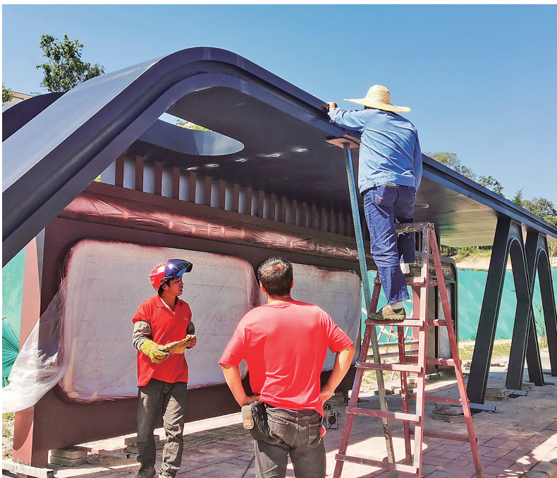
近日,施工人员在复兴大道两旁安装了一批新型候车亭,建成后将为沿线公交乘客候车提供便利。 茂名日报社全媒体记者岑稳 摄
