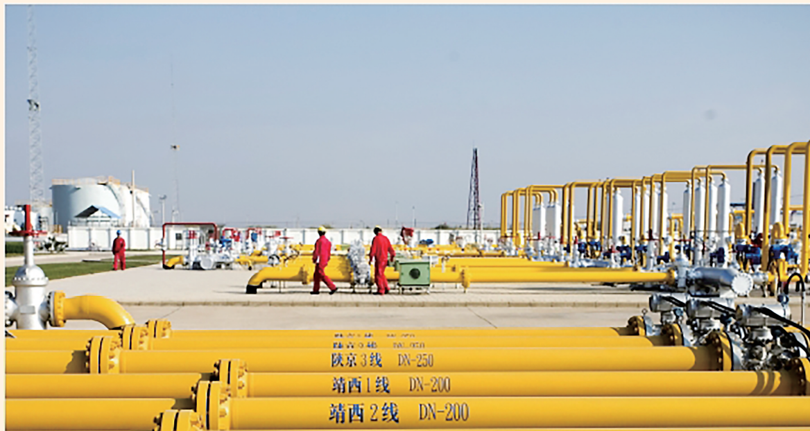
长庆油田天然气管道枢纽。(长庆油田供图)
