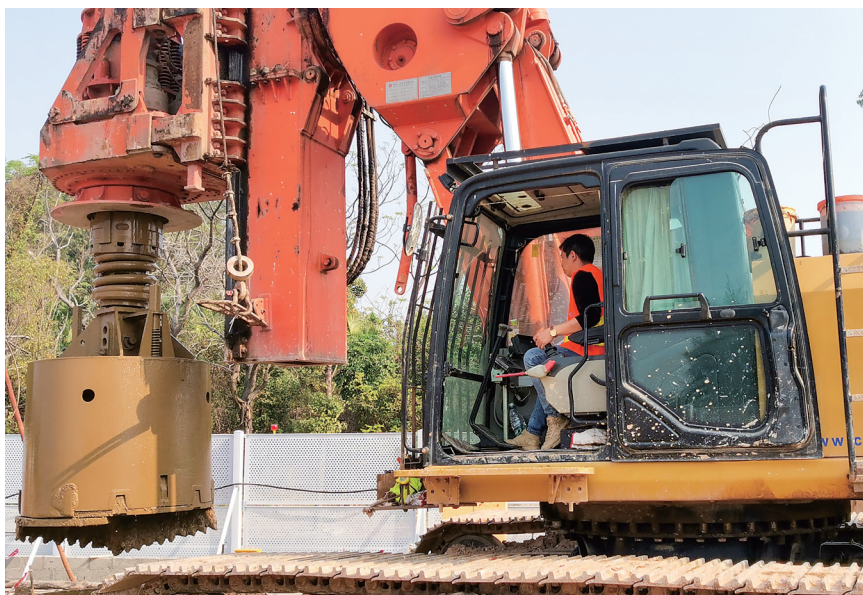
海洋大道立交项目首桩开钻。茂名日报社全媒体记者 岑稳 摄
