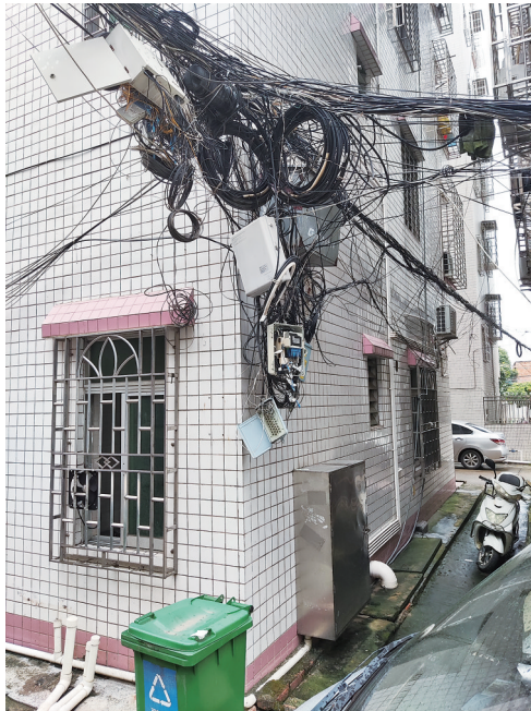
整治前线缆松散凌乱。
