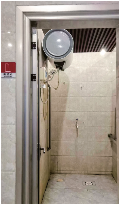
►沈海高速电白服务区安装的便民热水淋浴间。 茂名日报社全媒体记者李颜东 摄
