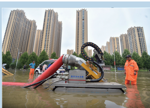
7月31日,在河北省石家庄市裕华路一处积水路段,工作人员进行紧急排水。 新华社发
