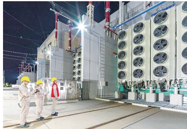
8月7日,在福建省漳州市,国网福建省电力有限公司超高压分公司运维人员巡视闽粤联网工程云霄换流站。(谢春雷 摄)
