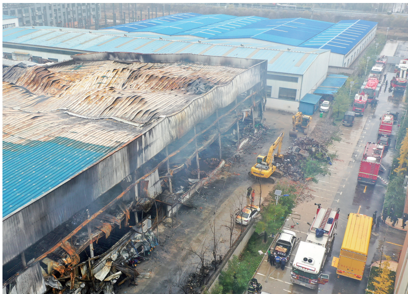
2022年11月22日,消防救援人员在河南安阳火灾现场(资料图片)。新华社记者李嘉南摄
