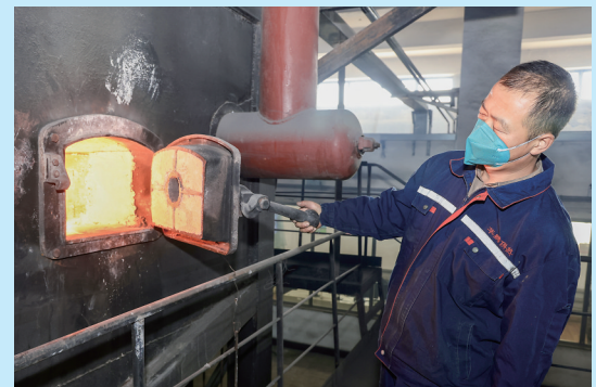
9月14日,工人在锅炉房内作业。(漠河市委宣传统战部供图)
