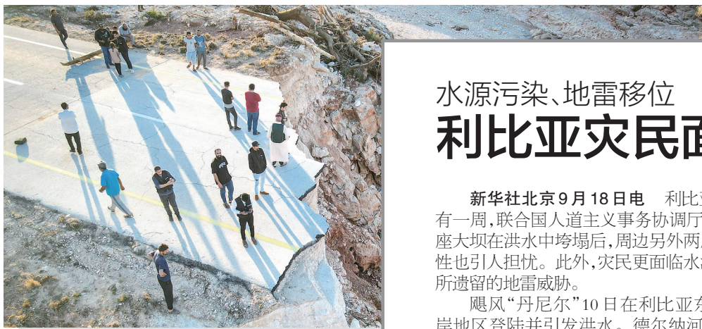
这是9月15日在利比亚东部德尔纳附近拍摄的被毁的桥梁(航拍照片)。新华社发(易卜拉欣·哈迪娅·马吉卜里摄)
