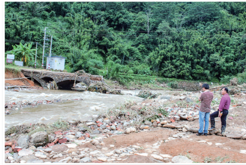
▲利乡桥中间桥面已坍塌,部分断掉沉入河中。
