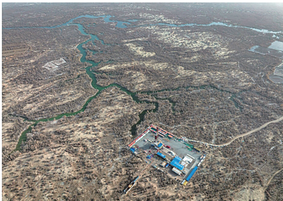
11月15日拍摄的中国石化“深地一号”跃进3-3XC井(无人机照片)。新华社记者肖艺九摄
