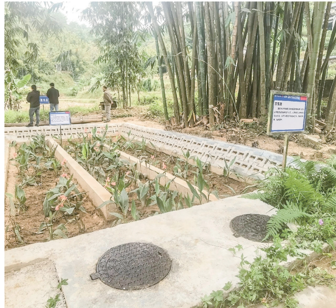
农村生活污水处理设施。茂名晚报通讯员曾碧玉 摄
