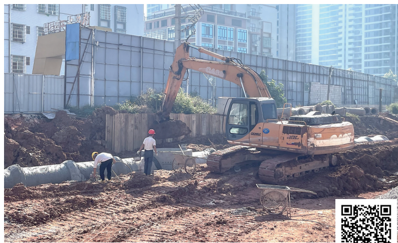
2023年12月31日,元旦假期第二天,市区人民南五、六路项目建设工人坚守岗位,加紧铺设雨污管网,争取道路早日建成通车。
