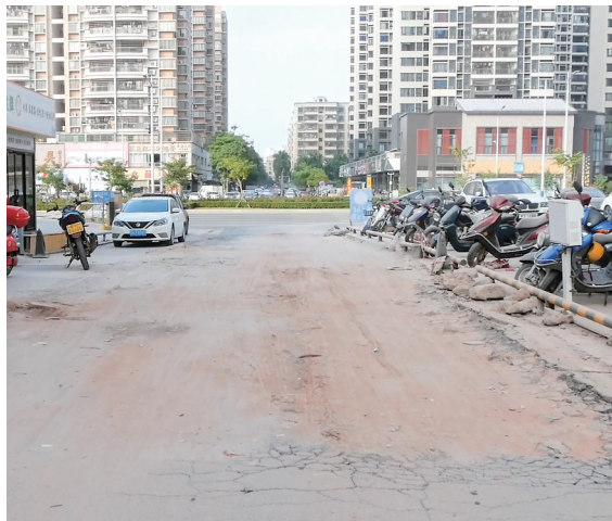
路面凹凸不平,损坏严重。茂名晚报记者 黄宇彬 摄
