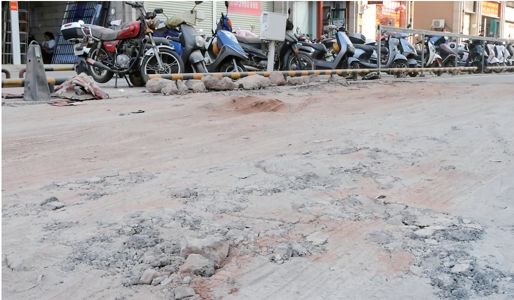
破损的路面露出黄泥、石头,不时有石灰粉扬起。茂名晚报记者 黄宇彬 摄
