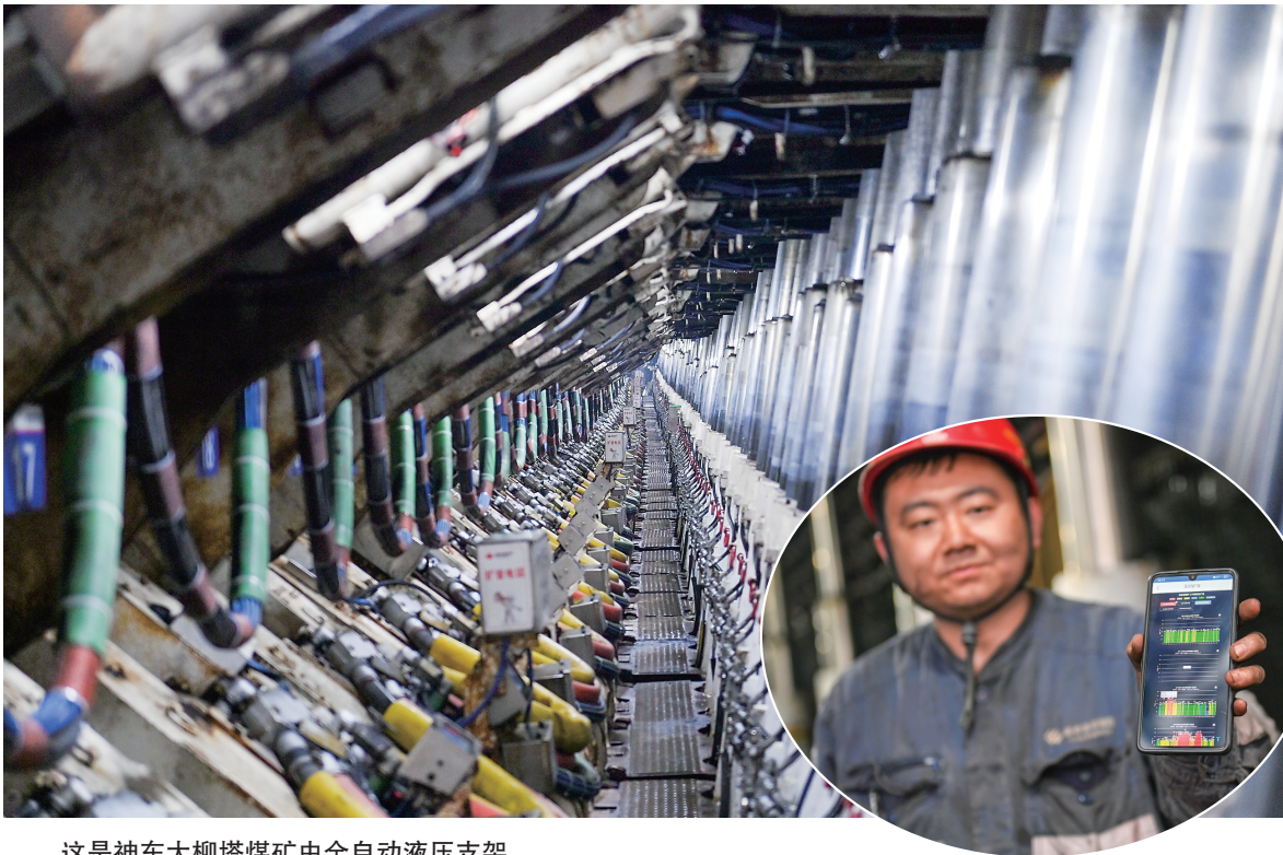
这是神东大柳塔煤矿由全自动液压支架支撑的采煤工作面。新华社记者李一博 摄
