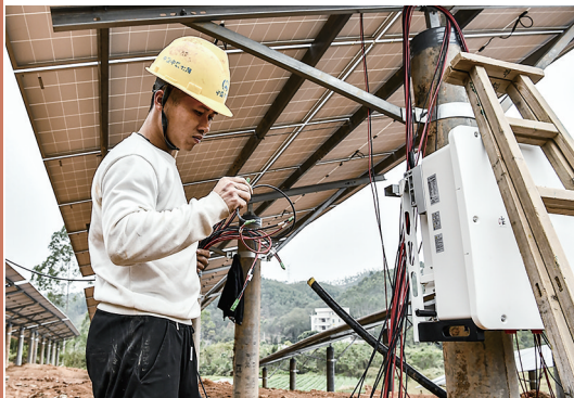
在光伏场区,施工人员在认真检查电线组件。 茂名日报社全媒体记者甘杨松 摄
