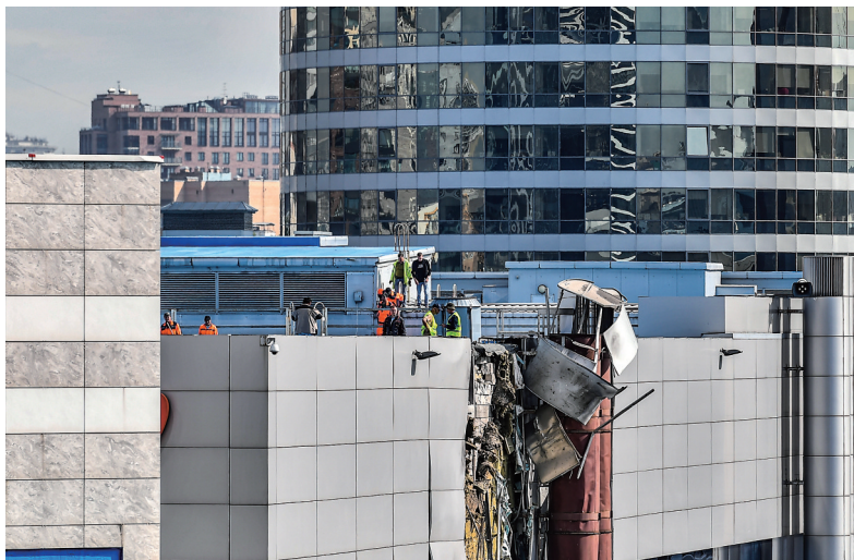
这是2023年8月18日在俄罗斯莫斯科拍摄的受损建筑。俄罗斯国防部18日表示,俄方当天挫败了乌克兰方面使用无人机袭击莫斯科的企图,事件未造成人员伤亡。新华社记者曹阳摄
