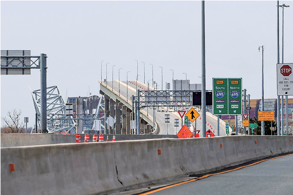
这是3月26日在美国马里兰州巴尔的摩拍摄的坍塌的大桥。新华社记者胡友松 摄
