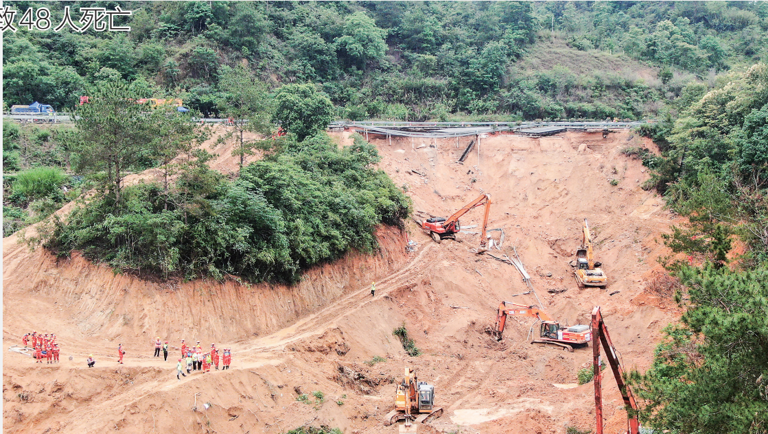
救援力量在广东梅大高速茶阳路段塌方灾害现场作业(5月2日摄,无人机照片)。新华社记者 王瑞平 摄
