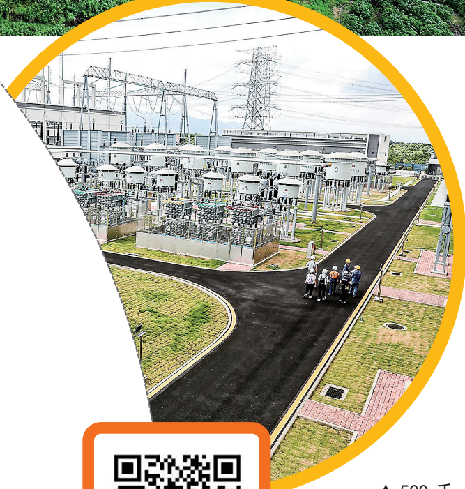
▲ 500千伏电白变电站。
