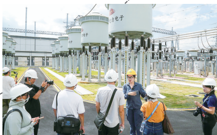
媒体记者参观500千伏电白变电站。
