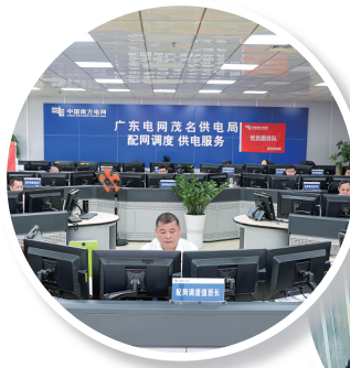
◀ 茂名供电局电力调度控制中心落实潮汐值班机制工作,全力投入电力保供工作。陈美影 摄
