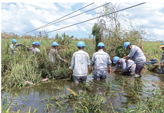
对10千伏三江湾线进行抢修,抢修人员需涉险水、度险滩,处理倾倒在地的导线。林海满 摄
