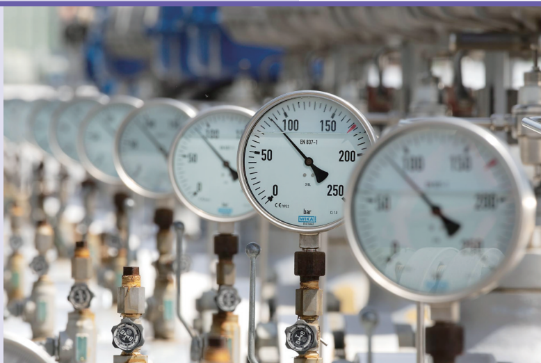
◀ 这是2022年5月20日在匈牙利饶瑙拍摄的匈牙利最大天然气存储设施。新华社发(弗尔季·奥蒂洛摄)
