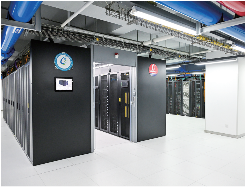
多模态地理科学大模型“坤元”的运行机房(新华社记者李鑫 摄)
