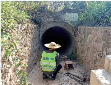
烈日下,包茂高速路巡员欧朝怀认真排查高速公路排水系统。
