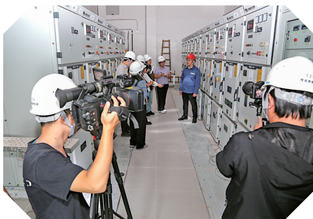
在10千伏奥体中心公用配电站，茂港供电局工程建设人员介绍工程进展情况。
