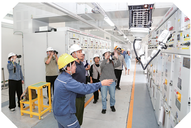
媒体记者走进化州110千伏新安变电站，近距离采访“梦达1号”智能巡操机器人工作情况。
