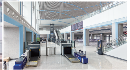
各类设备设施已安装完成。 茂名日报社全媒体记者 张波 摄
