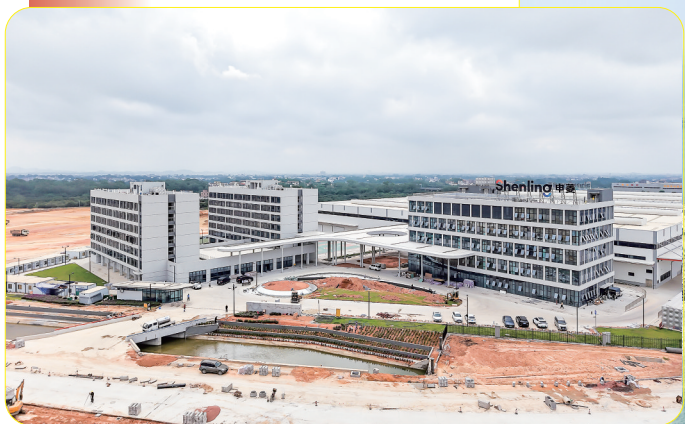
位于金石产业带的申菱空调厂。 茂名日报社全媒体记者 周泽佳 摄
