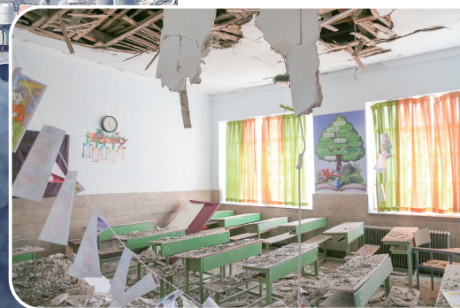
3月3日,在伊朗德黑兰市中心的沙希德·马哈拉提学校,教室房顶塌落,地面一片瓦砾。新华社记者 沙达提 摄
