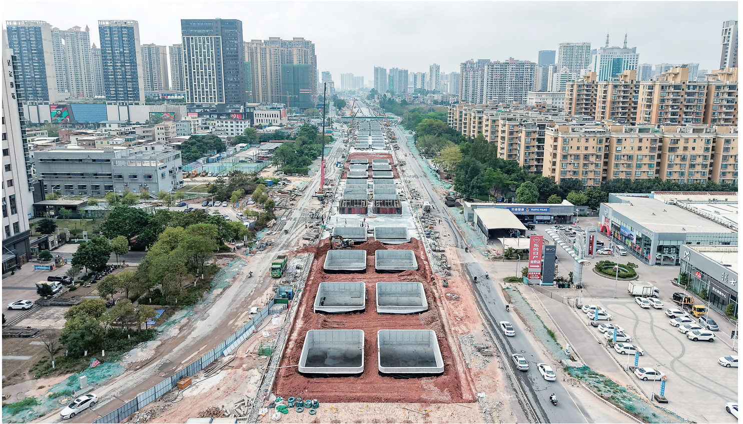
省道S208线(茂名大道)快速化改造项目三期隧道主体顺利完成。
