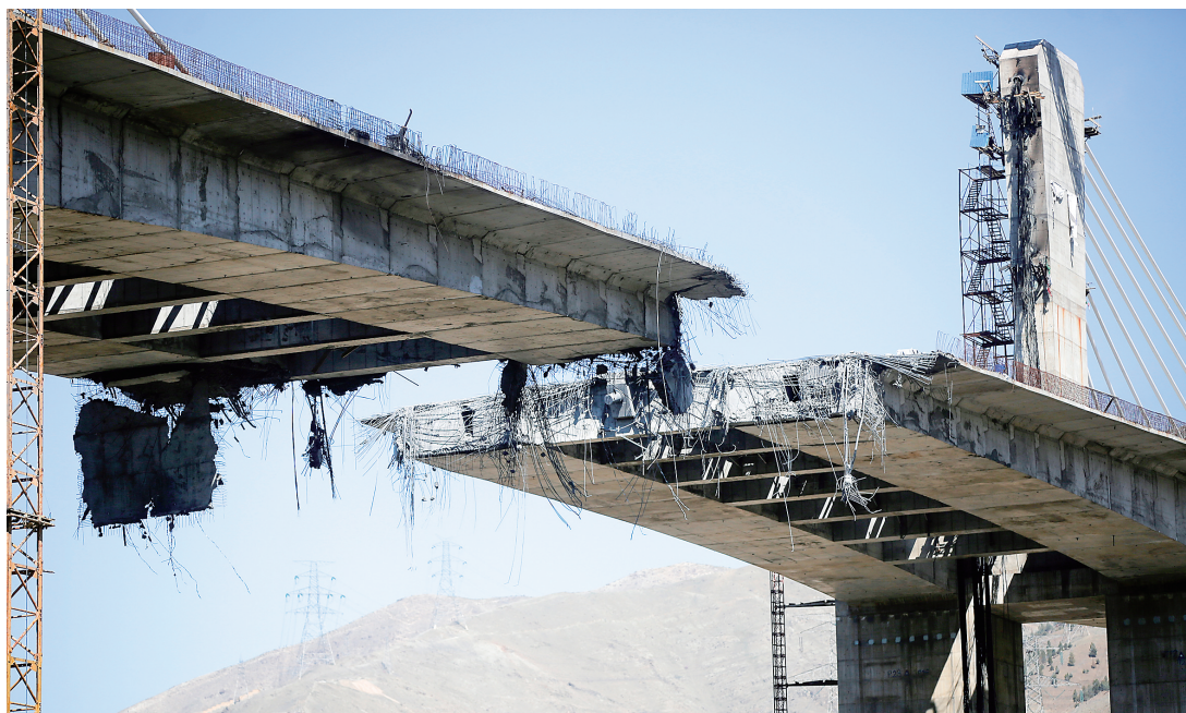
这是4月3日拍摄的伊朗卡拉季市贝伊克公路桥遭空袭受损状况。新华社发
