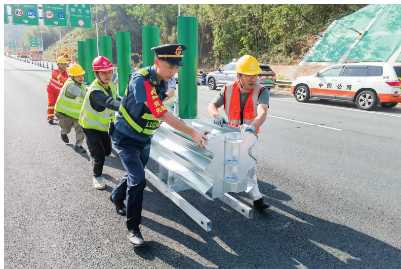
5月1日,广贺高速路政队员和养护工作人员在移除中央隔离护栏。 新华社发(朱国维摄)
