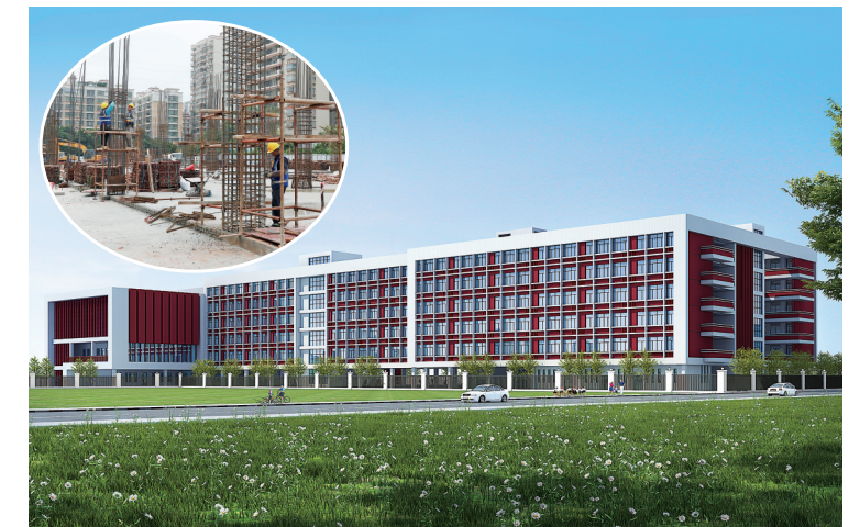
大图为福地小学效果图（小图为学校建设施工现场）。 茂名日报社全媒体记者 刘付思明 摄
