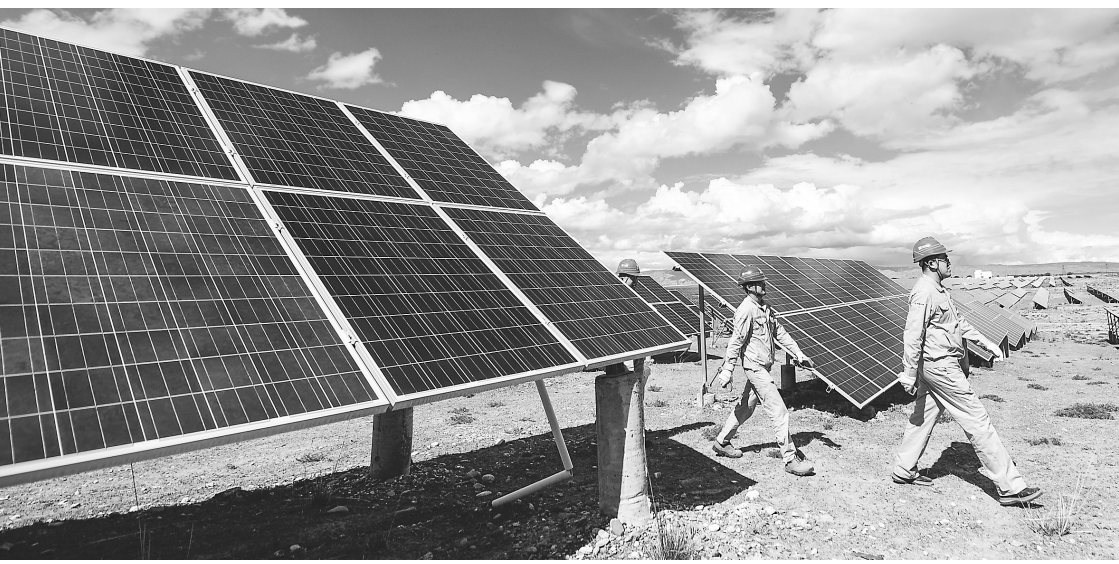
6月26日,大唐青海能源开发有限公司工作人员在青海省海南藏族自治州共和县塔拉滩光伏电站巡检。近年来,青海省海南藏族自治州依托土地资源和太阳能资源优势,着力推进新能源发电项目落地。截至目前,在位于共和县的海南州绿色产业发展园区,光伏、风电、光热新能源装机容量超过2000万千瓦。按测算,通过新能源发电这里每年可节约标准煤736.96万吨,减排二氧化碳2237.2万吨。新华社记者 张龙 摄
