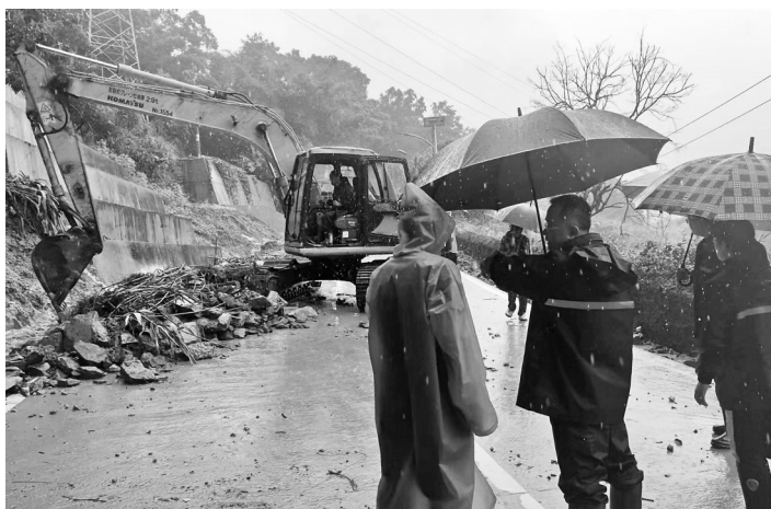
信宜市平塘镇平塘村道路抢险。个镇84个村委会的无线对讲系统和123台卫星电话全部调试完毕,均可正常使用。
