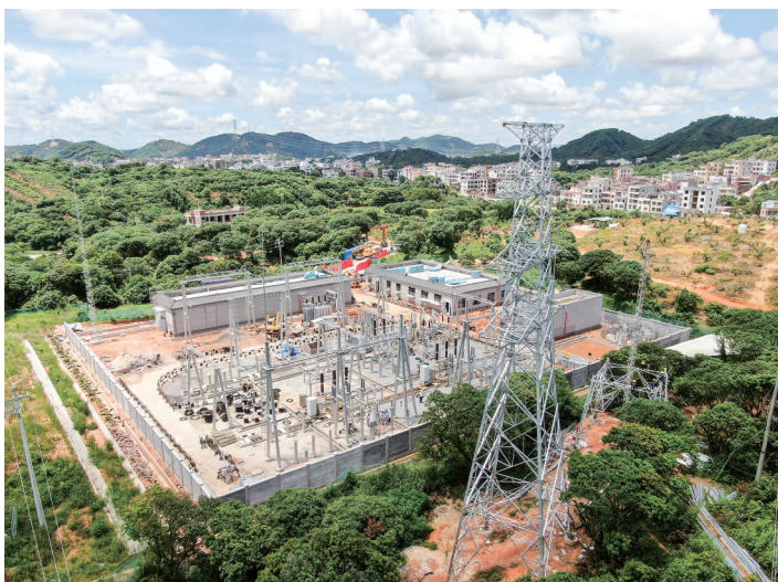
110千伏根子变电站的竣工投产,进一步为根子镇国家级荔枝现代农业产业园等重点乡村振兴区域提供电力保障。通讯员 叶泽 摄
